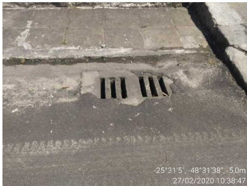
Figura 48: Boca de lobo na Avenida Governado Manoel Ribas.
