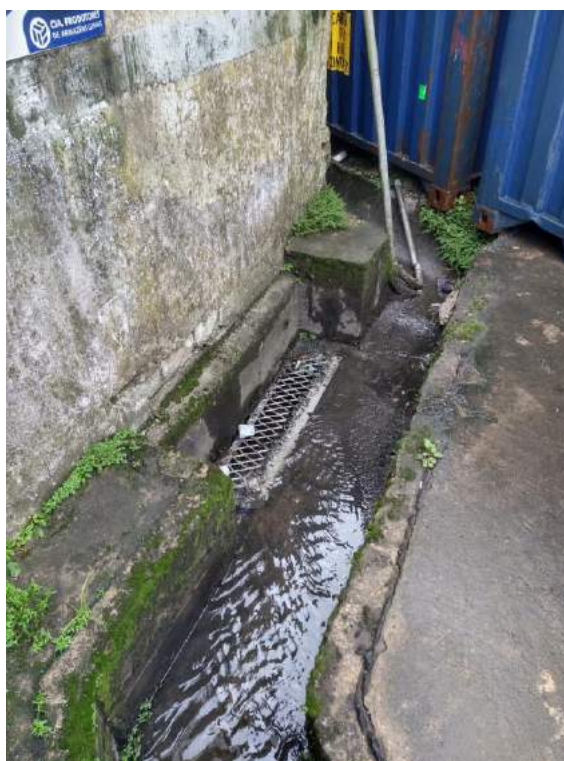
Figura 49: Boca de lobo dentro do empreendimento da Cia de Produtores.
